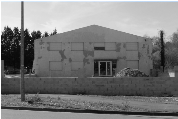
13-14. Etat de délabrement très avancé du bâti
